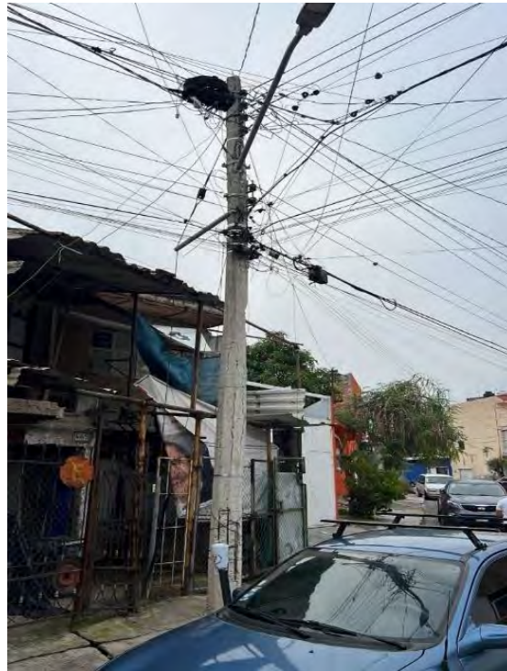
Ilustración 1. Foto de autoría propia de las "telarañas" de cableado en la ciudad de Guadalajara.
