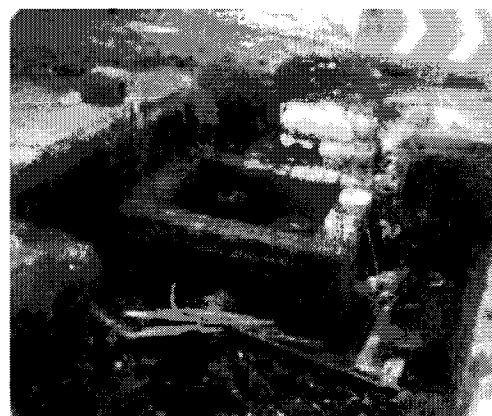
Imagen 30. Construcción de cajas operadoras de válvulas. Fuente: Informe de la Delegación Tláhuac.
