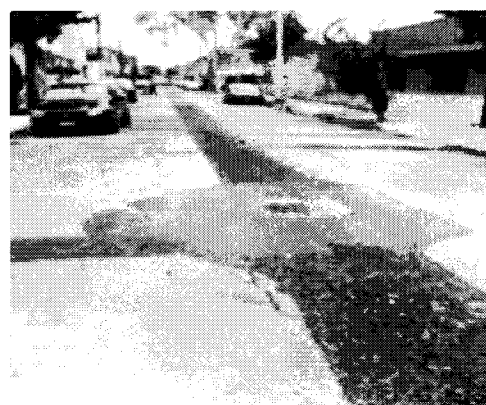
Imagen 29. Conclusión de trabajos obras de drenaje. Fuente: Informe de la Delegación Tláhuac.
