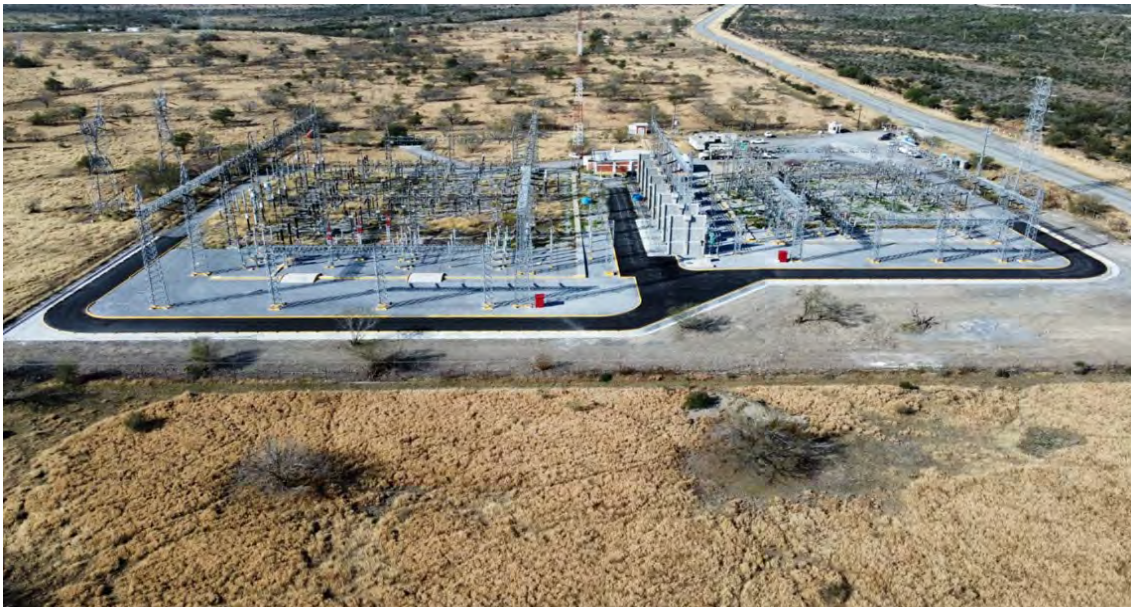
Fotografía: Panorámica de la SE Cuchillo
