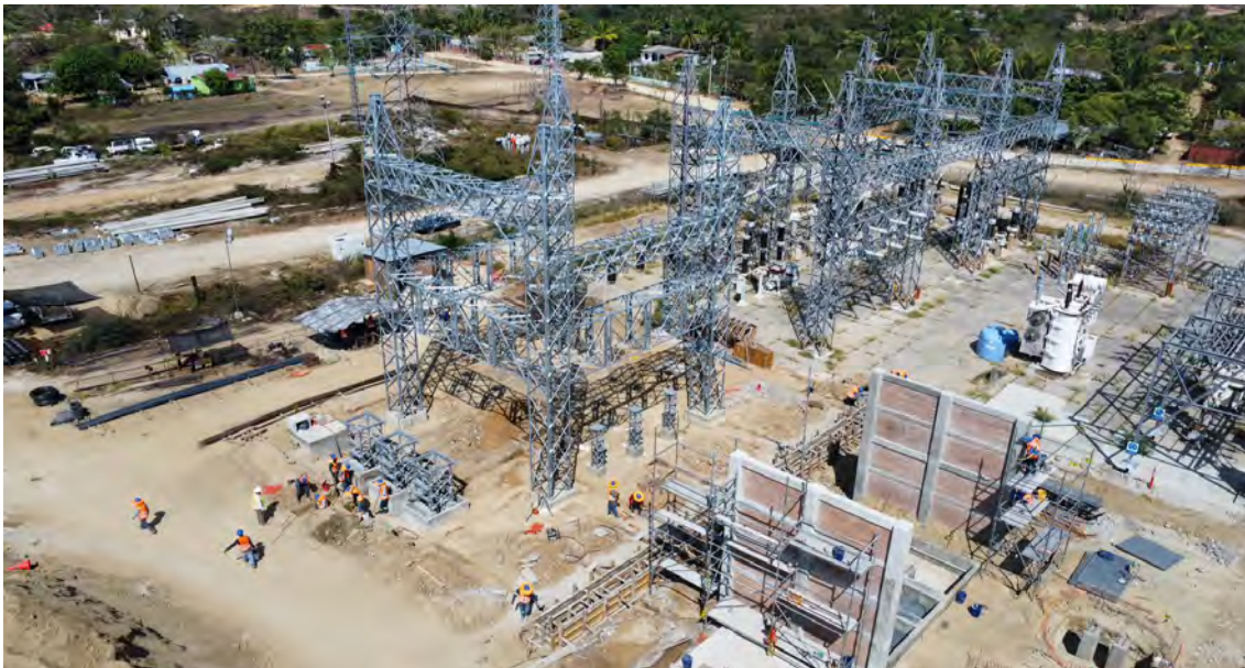
Fotografía: Subestación Pochutla STATCOM
