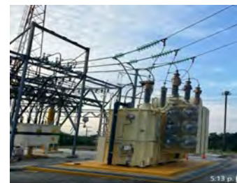
S.E. Valle Alto Banco 1 (Sust.)
