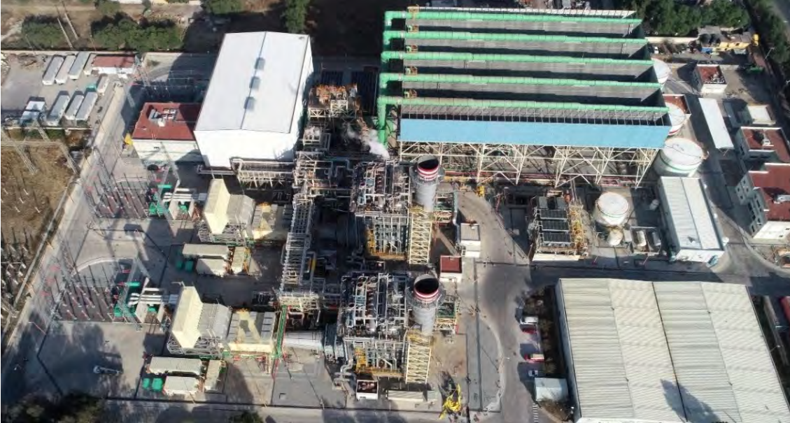
Fotografía: Panorámica de la CCC Valle de México II
