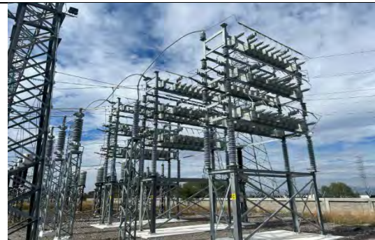
Ilustración 11. Banco de capacitores SE Querétaro Potencia
