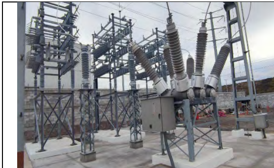
Ilustración 10. Banco de capacitores SE Parque Innovación
