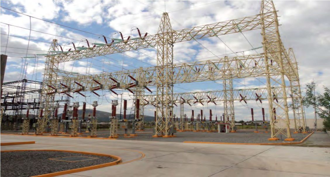
Fotografía: Subestación Zumpango Bcos. 1 y 2 (Sust.) + MVar
