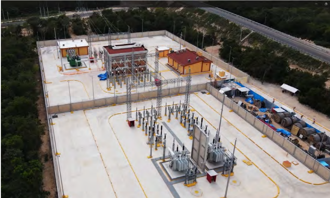
Fotografía: Subestación Eléctrica Tractora 1 y Subestación Eléctrica Maniobras 1
