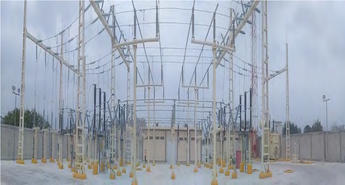
Fotografía: Subestación de Distribución Elena Banco 1 + MVar
